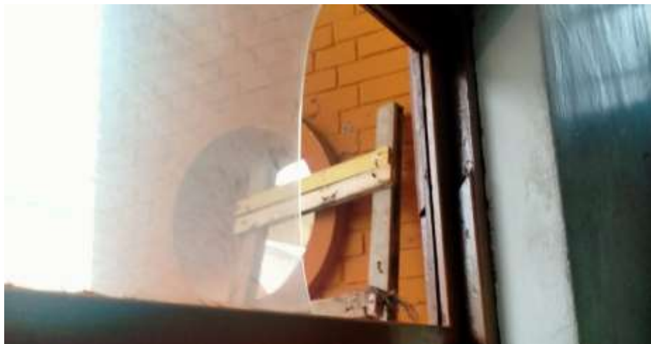
Gambar 1.1 Kerusakan pada Bangunan Gedung
